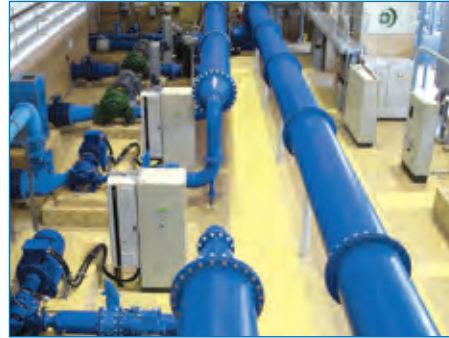
Reinwasserpumpwerk für die Trinkwasserbereitstellung
