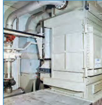
Kontaktkörperbelüftung zur Belüftung und Entsäuerung
