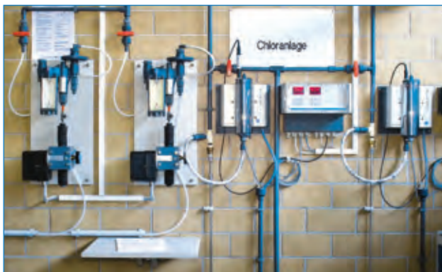
Lindauer Trinkwasser bedarf keiner Desinfektion. Es wird eine Desinfektionsanlage vorbehalten.
