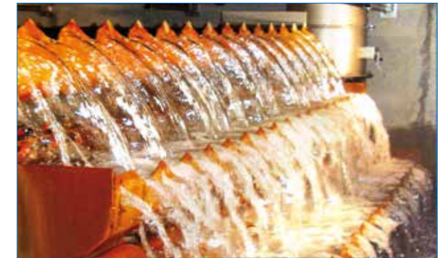
Kaskaden zur Belüftung / Entgasung Wasserwerk Colbitz
