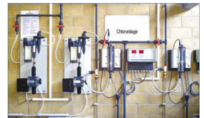
Desinfektionsanlage Wasserwerk Lindau
