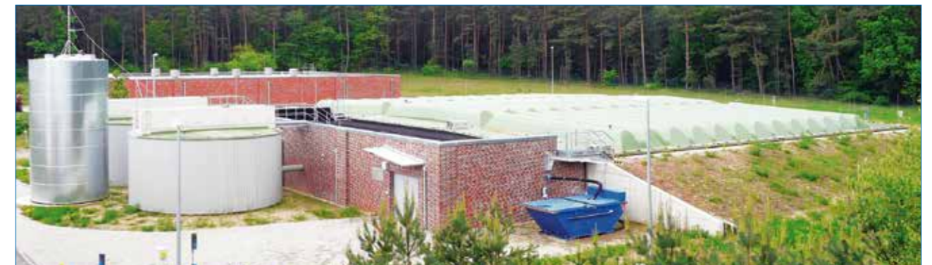
Filterspülwasserbehandlungsanlage Wasserwerk Colbitz
