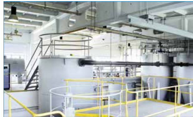
Kalkanlage zur pH-Wert Einstellung Wasserwerk Lindau
