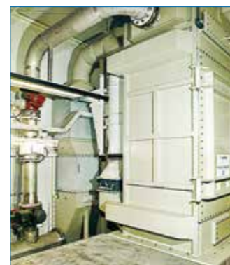
Belüftung und Entsauerung WW Lindau
