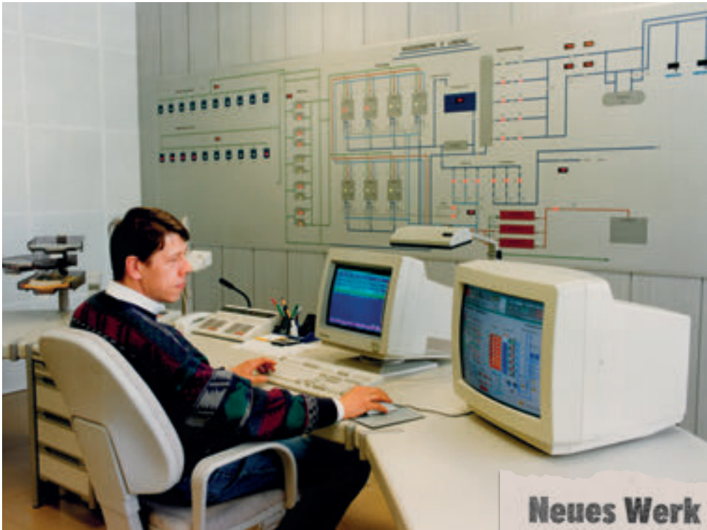
Kollege Wolfgang Richter in der Schaltzentrale des Wasserwerkes
