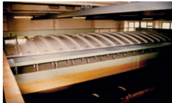
Blick auf die abgedeckten Mehrschichtfilter
