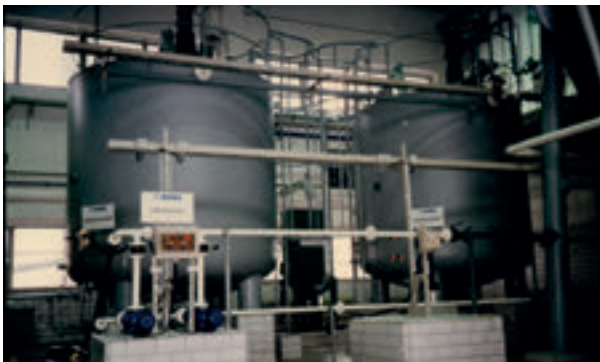
Die Anlagen für die Kalkdosierung zur Restentsäuerung
