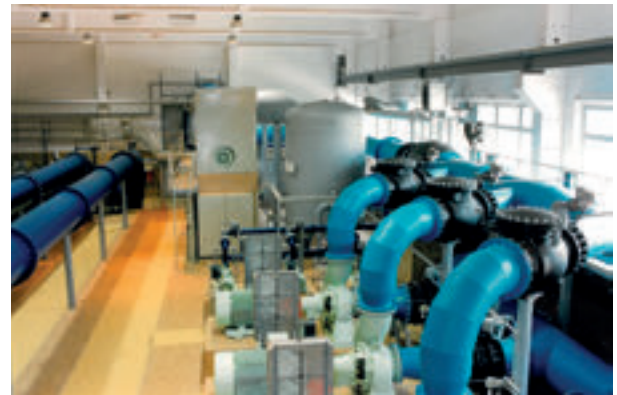
Blick in die Maschinenhalle des neuen Wasserwerkes Lindau
