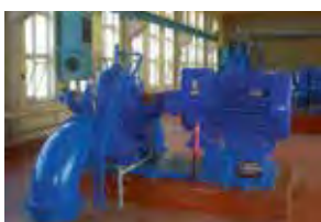
Pumpen für die Ohrewasserförderung
