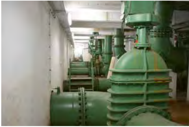
Saugleitungen und Schieber der Pumpen 1-4
