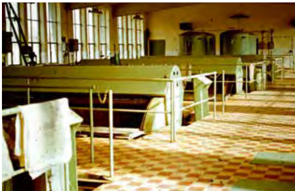
Die Mikrosiebfilteranlage als Vorreinigungsstufe
