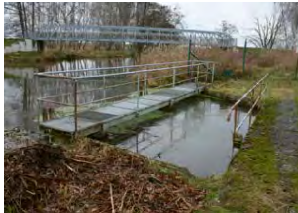
Zulauf von der Ohre zum Vorbecken des Pumpwerks Satuelle
