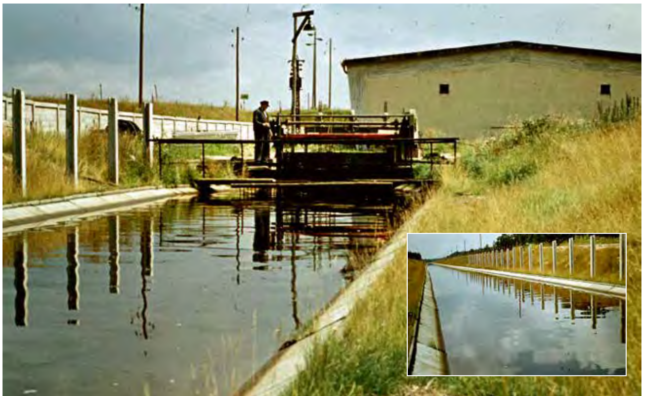
Schlitzrechenreiniger zur Entfernung der Algen. Kleines Bild: Der 10 km lange offene Ohre-Heide-Kanal
