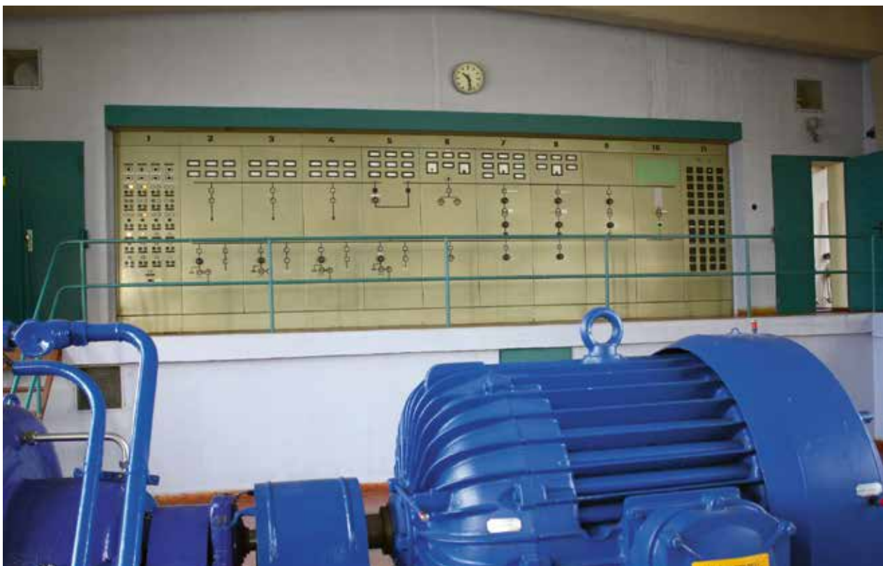
Schaltanlage mit Fließbild der Pumpen
