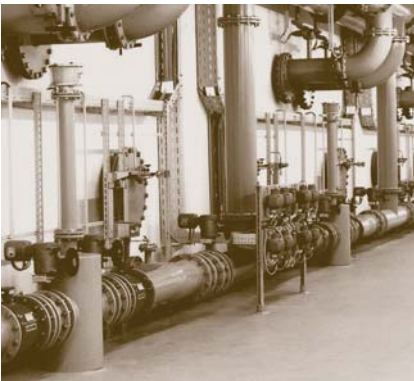
Filteranlagen zur Entfernung von Eisen und Mangan aus dem Grundwasser
