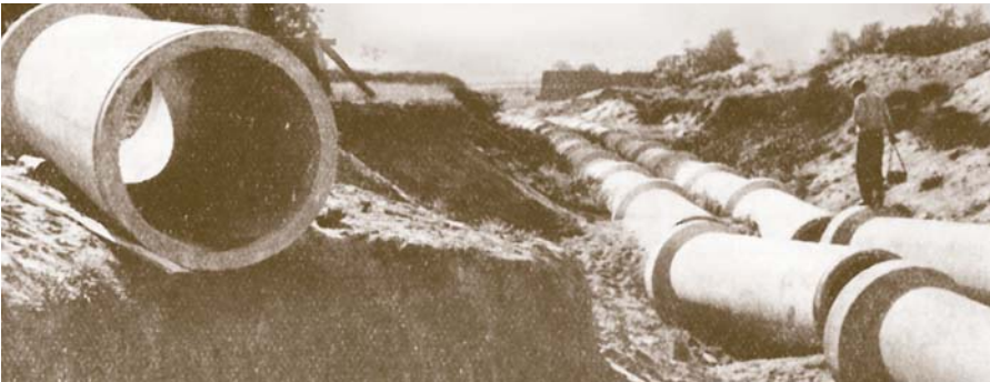
Druckleitungen am Detzel-Berg zur Ohrewasserförderung
